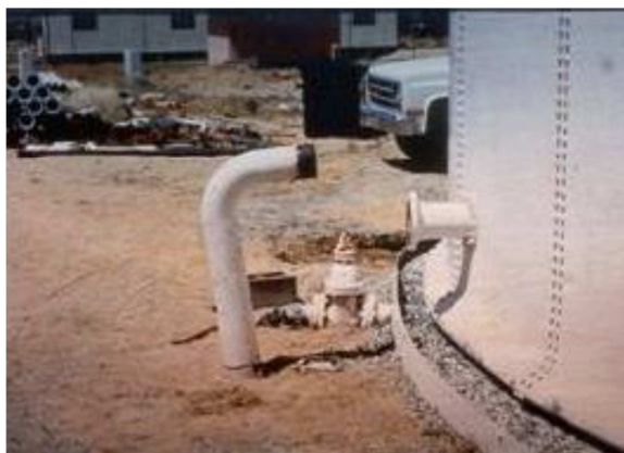
Figura 21:Terremoto di Landers (CA), 28/06/1992, Mw=7.3: danni alle tubazioni rigide
