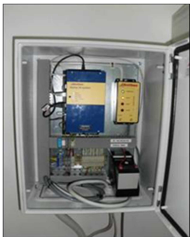
Figura 63: sistema di rilevazione sismica: centralina allarmi (Fonte: Italmatch Chemicals S.p.A.)
