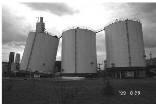
Figura 26 danneggiamento serbatoi per gas liquefatti.
