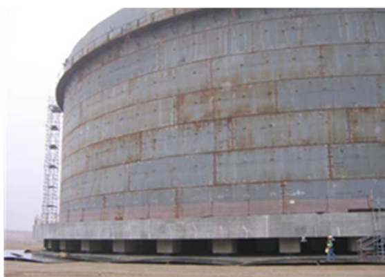
Figura 27 - Pampa Melchorita (Perù): serbatoio LNG da 130.000 m 3 protetto da isolatori sismici (a scorrimento a triplo pendolo)
