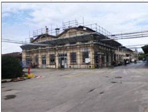
Figura 59: Lavori di adeguamento sismico degli edifici dei reparti pentasolfuro, sesquisolfuro e centrale termica
